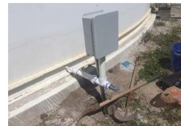
6. ER PROBE ENCLOSURE B
